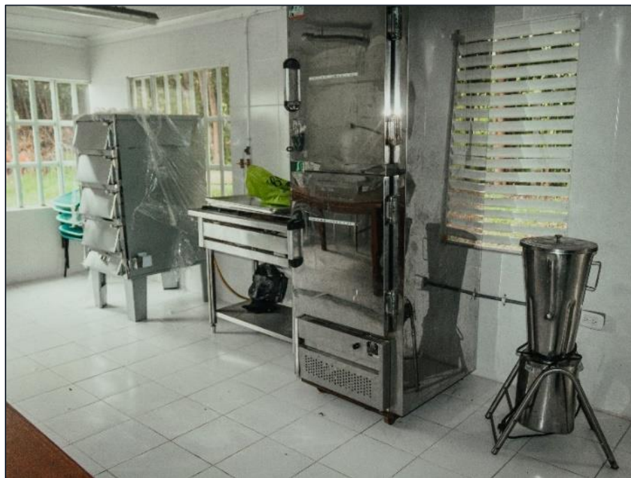
Ilustración 3. Equipos de operación ubicados en el primer espacio de operación de la planta de procesamiento de alimentos IEO Eugenio Díaz Castro
